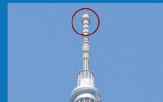
「制振装置」は、放送用アンテナを支えるゲイン塔の最先端部に設置されている。
