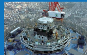
東京スカイツリー®の建設中に、地上497mの塔体頂部に仮置きされた「制振装置」。写真提供:大林組
