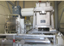
有明自動車営業所 水素供給設備
