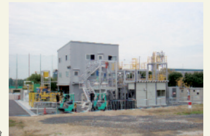
バイオエタノール製造実証施設
