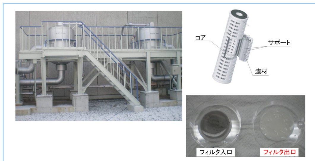
図4 低圧給水加熱器ドレン系統 鉄除去装置の外観
