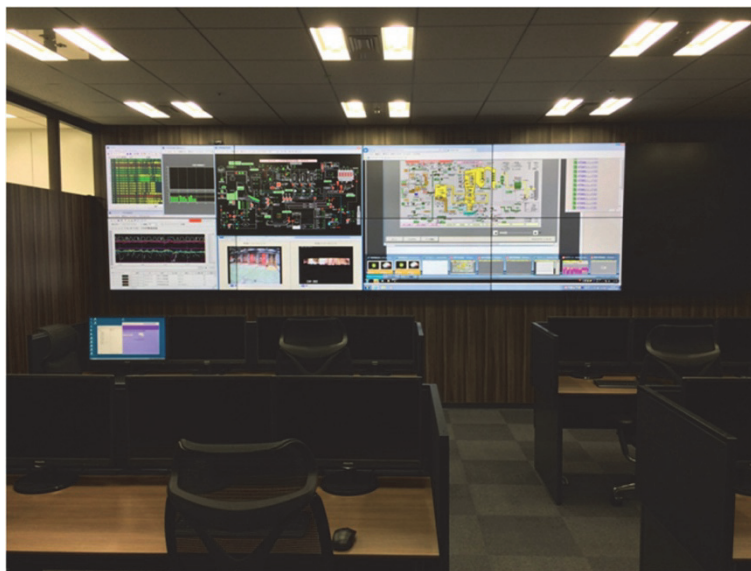
図7 遠隔監視・運転支援センター
