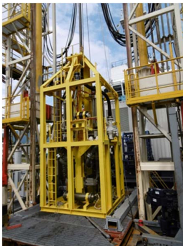
図6 水中ポンプユニット
