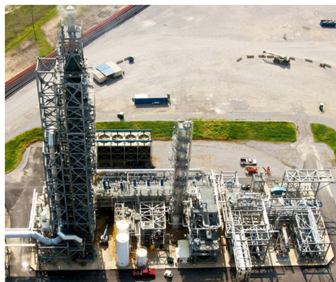
図2 米国 Southern Company 向け CO 2 回収実証機外観
