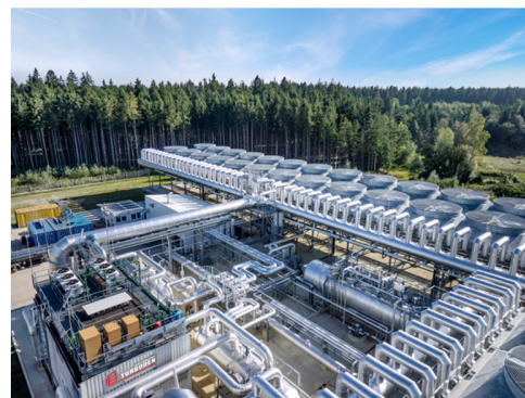
図8 ドイツの既設バイナリ発電システム
