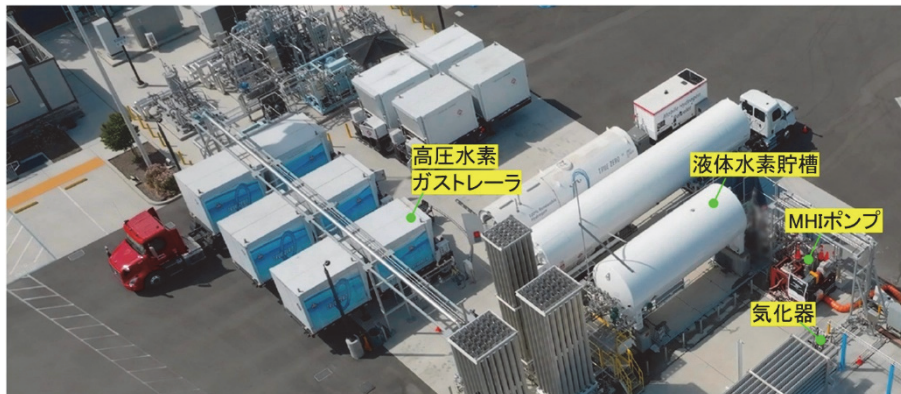
図6 ファーストエレメントフューエル社運営の水素供給設備
