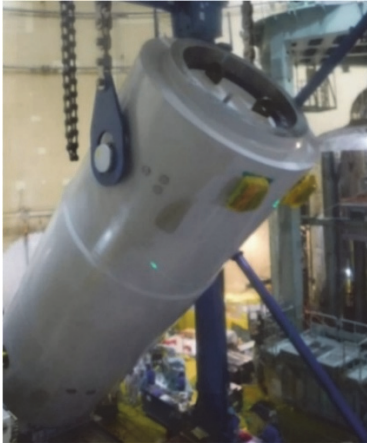
図1 CV 内特設クレーンによる旧 CI 遮へい容器横倒し状況
