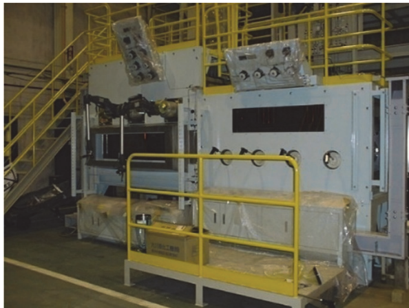
図 14 分析装置類の遠隔操作性の検証設備
