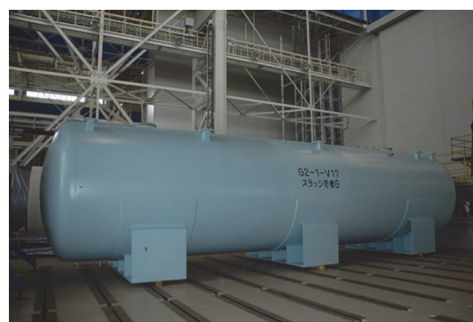
図3 スラッジ貯蔵タンク
