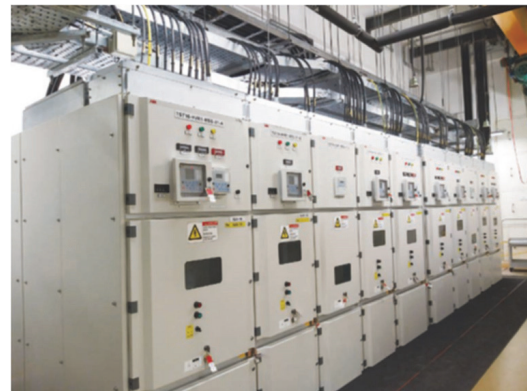
図10 電力供給機器室
