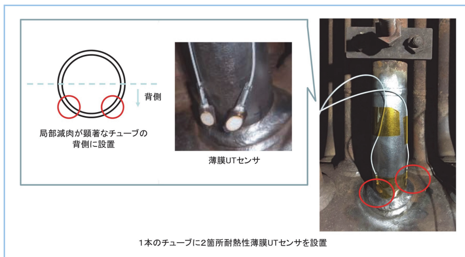
図5 薄膜 UT センサ 設置箇所
