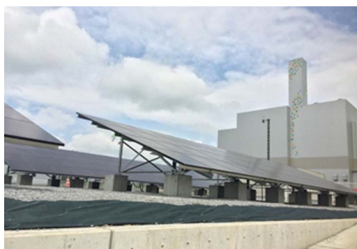
図6 太陽光発電設備
