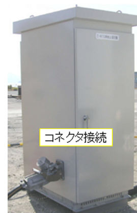
図7 地上給電設備
