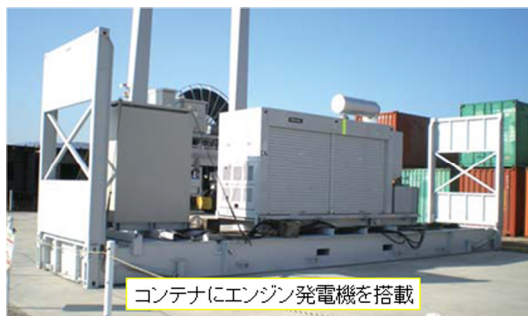
図8 電源搭載コンテナ
