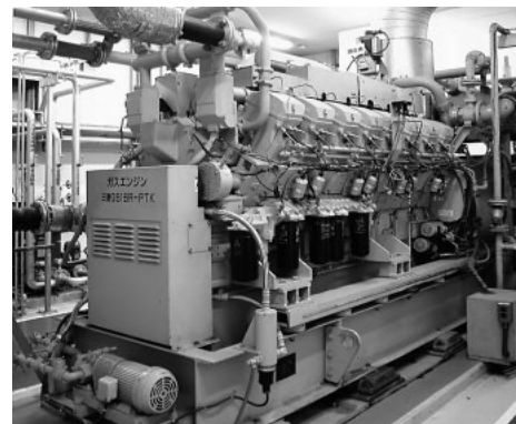
図2 GS16Rミラーサイクルガスエンジン 汎特内第4発電所に設置され、工場に電力と蒸気・温水を供給するコージェネレーションシステムとしている。お客様の稼働状態での検証としても活用。
