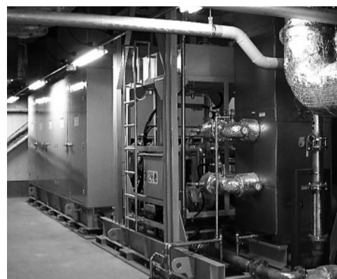
図8 稼働中のGSRパッケージ 温水回収仕様で稼働中のGS12Rの外観。
