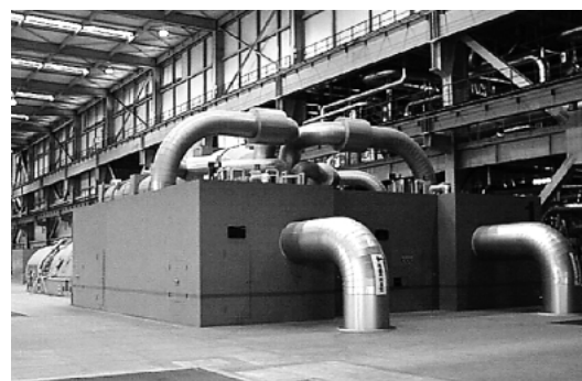
図4 蒸気タービン外観
