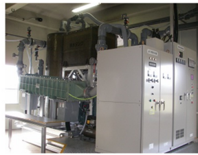
電解脱室素処理装置
