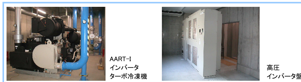
図5 機器設置状況
