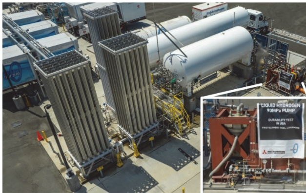
図7 FEF 社試験場に設置した当社製液体水素昇圧ポンプ
