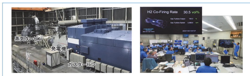
図5 当社 GTCC 実証発電設備の最新鋭 JAC 形ガスタービンと中央操作室
