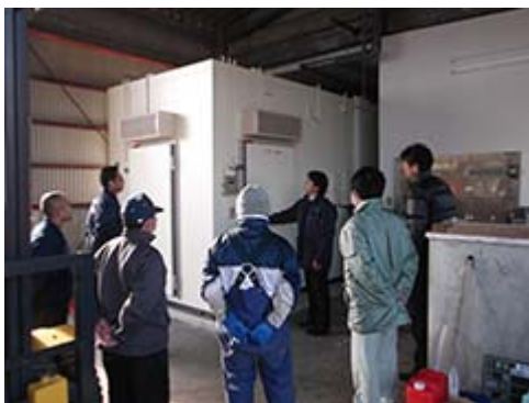
設置後のプレハブ冷凍冷蔵ユニット
