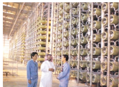
海水淡水化プラント内の様子
