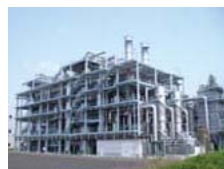
「東京都東部スラッジプラント」 向け下水汚泥炭化設備
