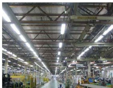
汎用機・特車事業本部の工場内照明
