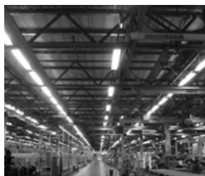
汎用機・特車事業本部の工場内照明
