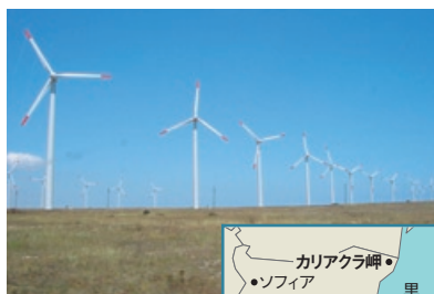
ブルガリア初の風力発電設備。35基の大型風力発電設備からなる黒海沿岸のカリアクラ岬に建設。
