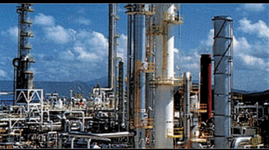
CO 2 回収装置
