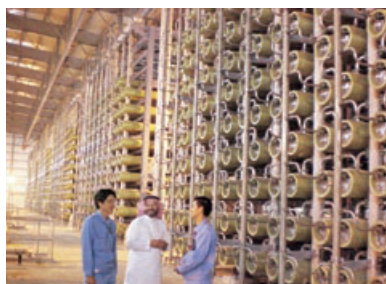
プラント内の逆浸透モジュールラック
