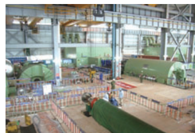
惠州発電所の内部
