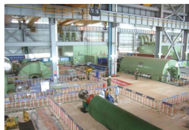
惠州発電所の内部
