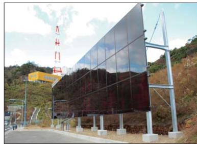
諫早工場で製造している太陽電池パネル57枚を 長崎県に寄贈
