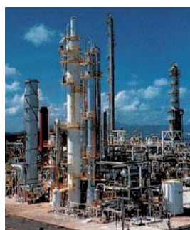
CO 2 回収プラント
