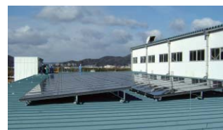
紙・印刷機械事業部に設置した太陽電池パネル
