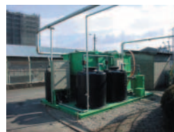
稼動を開始した浄化プラント
