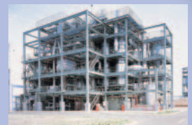
●水質汚濁防止装置
