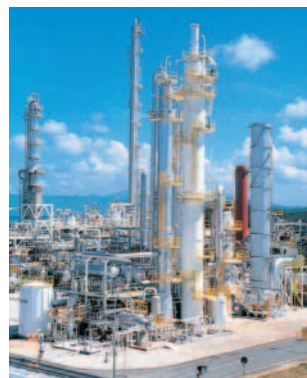
CO 2 回収技術を導入した 尿素製造用プラント
