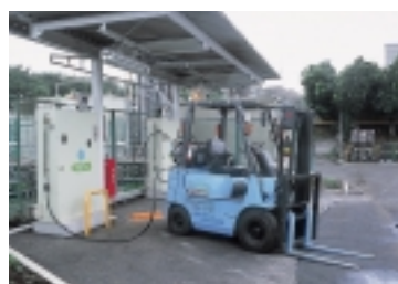
CNG 供給スタンド
