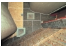
ストーカ炉内部の様子
