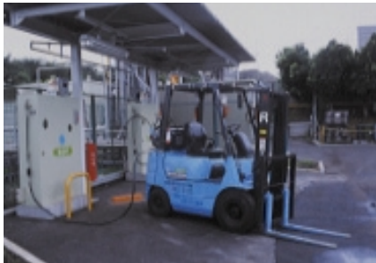
CNG供給スタンド
