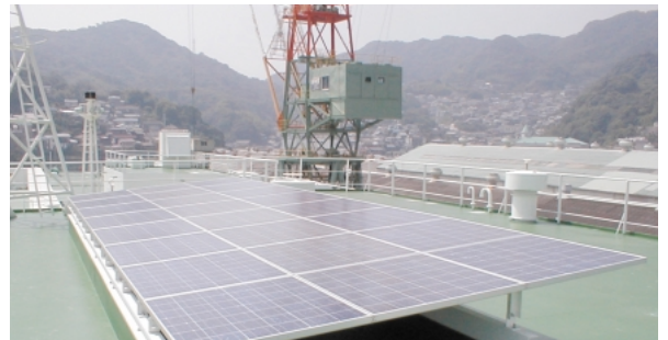
太陽光発電システム
