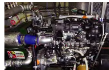
小型エンジン試験設備
