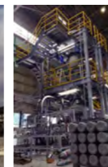
ターコイズ水素製造試験設備
