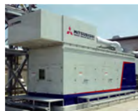
エンジン発電機
