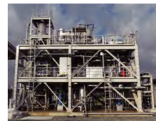
バイオジェット燃料製造設備
