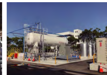
アンモニア供給設備
