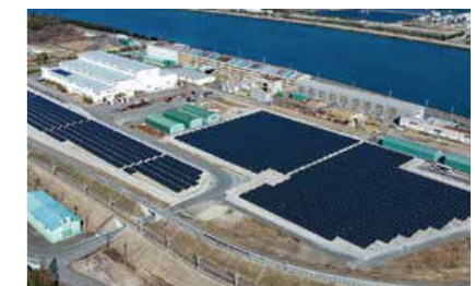
太陽光発電設備(三原製作所)
