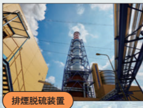
排煙脱硫装置
