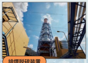
排煙脱硫装置
