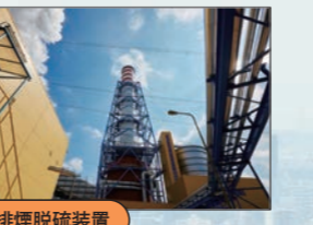
排煙脱硫装置
