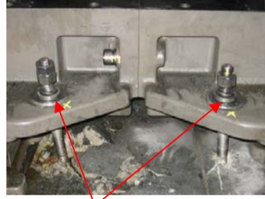
固定ボルトが浮いている
