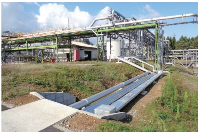
株式会社INPEX OGL炭酸事業関連工事の内 供給設備装置工事 竣工：2021年
