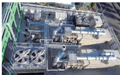
富双合成株式会社 コージェネレーション設備 竣工：2020年
