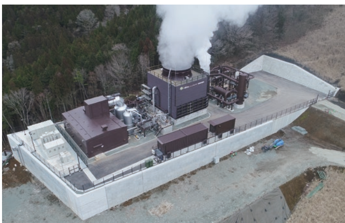
小国町おこしエネルギー地熱発電所設置工事 5MW級地熱発電設備工事の内 土木工事 工事内容:地熱発電(シングルフラッシュ方式) 4990kW 竣工:2024年
