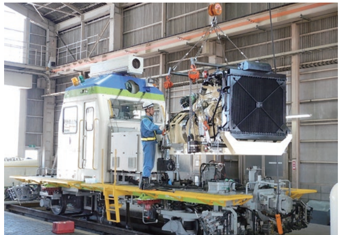
確認車・保全車の保守点検
