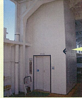
車両区画エレベータケーシング
