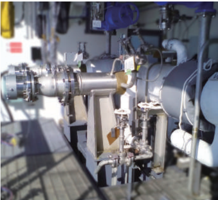
LNGバンカーステーション
