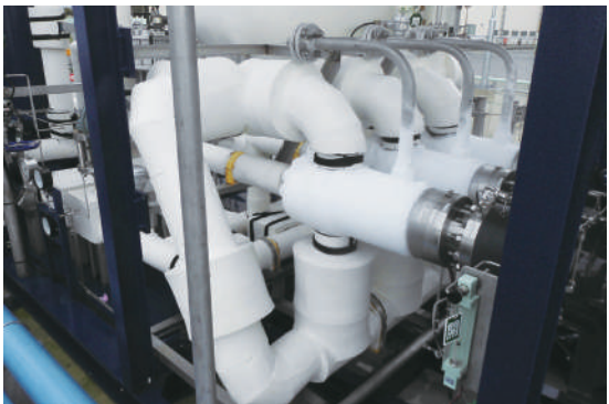
高圧LNGポンプ
