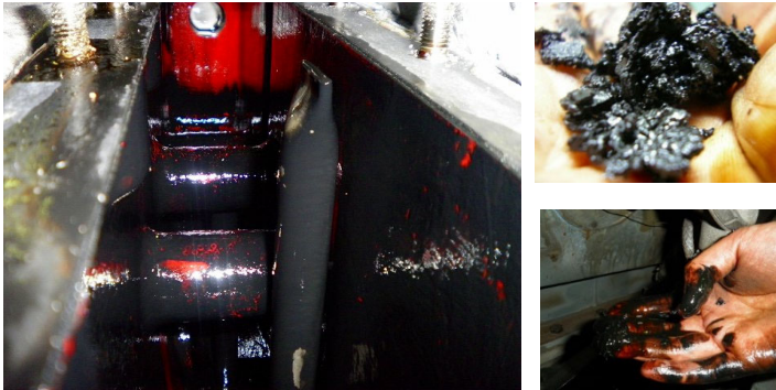
沉积在油箱底的淤泥
