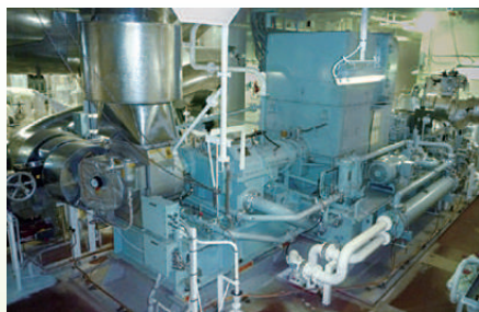
鉾石運搬船内に搭載したMERS発電機
