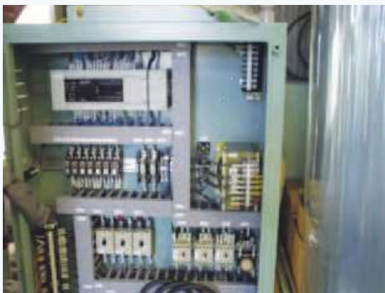
コントロールパネル内のシーケンサ(制御装置)
