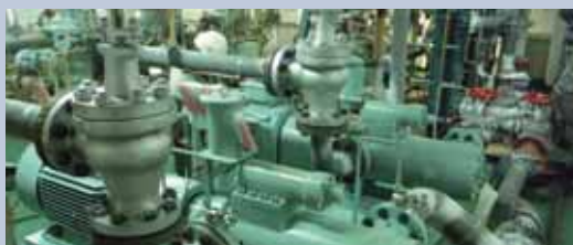
改造工事対象となる燃料ポンプ
