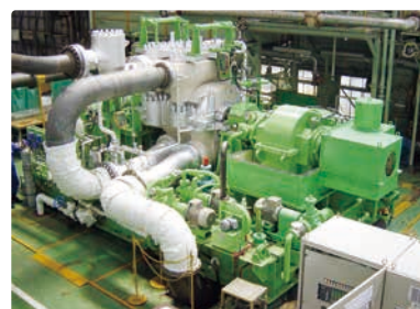
発電用蒸気タービン
