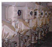
温度調節弁(3方弁) ポンプ室設置例
