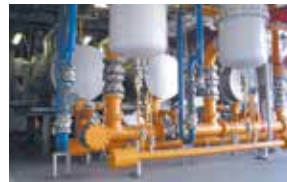
超低温冷却設備
