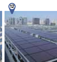
太陽光発電システム
