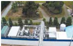
高効率CO 2 /NH 3 カスケード二元冷凍システム
