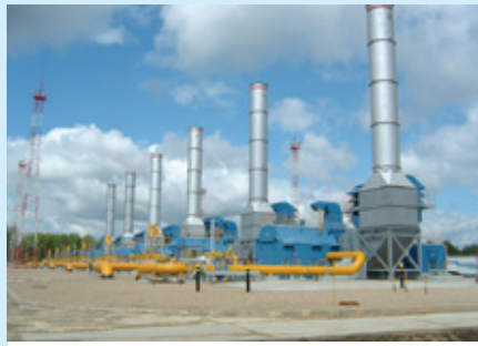
K ガス圧送用圧縮機 (パイプラインプースター)
