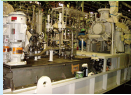
L 石油精製用循環ガス圧縮機
