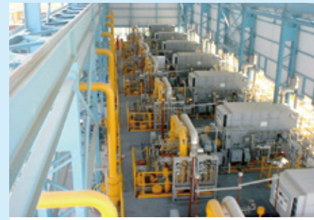
J 発電ガスタービン用燃料ガス圧縮機
