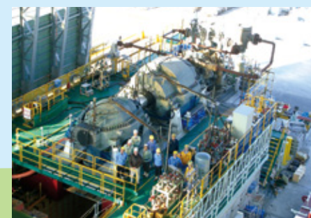
C LNG 生産設備用圧縮機
