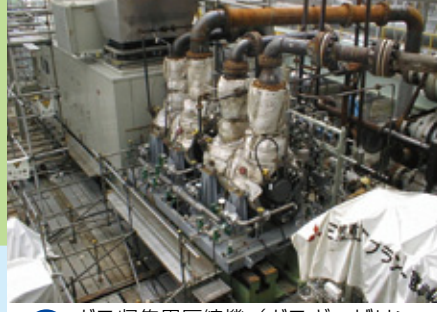
A ガス収集用圧縮機 (ガスギャザリング)
