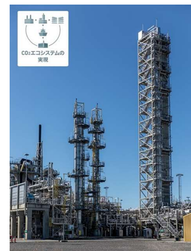
モンスタッドCO 2 回収技術センター（TCM）提供
